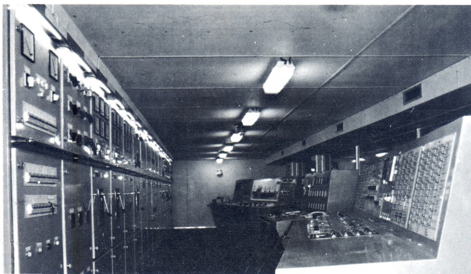
Cabina de control.
